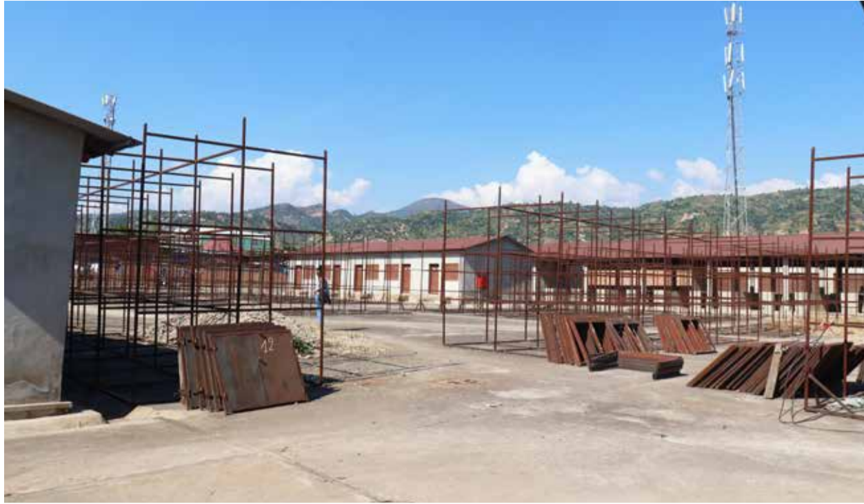
(Marché de Kanyosha) : Les travaux de réhabilitation du marché de Kanyosha sont à l'arrêt depuis plusieurs mois.
