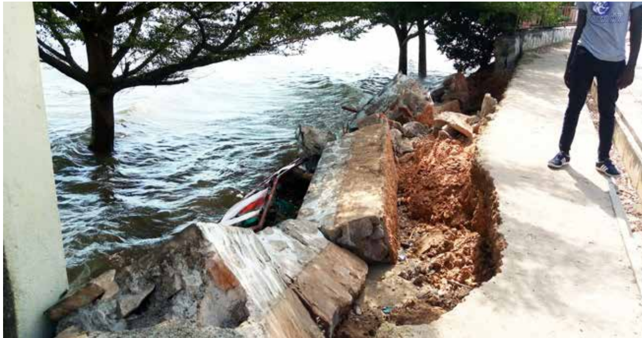
Les crues du lac Tanganyika constituent une menace réelle pour les infrastructures érigées le long du lac Tanganyika.
