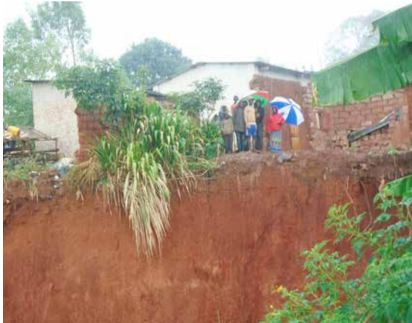
Les infrastructures construites le long du ravin qui sépare les quartiers Mukoni et Muyinga au chef-lieu de la province Muyinga sont menacées d'effondrement
