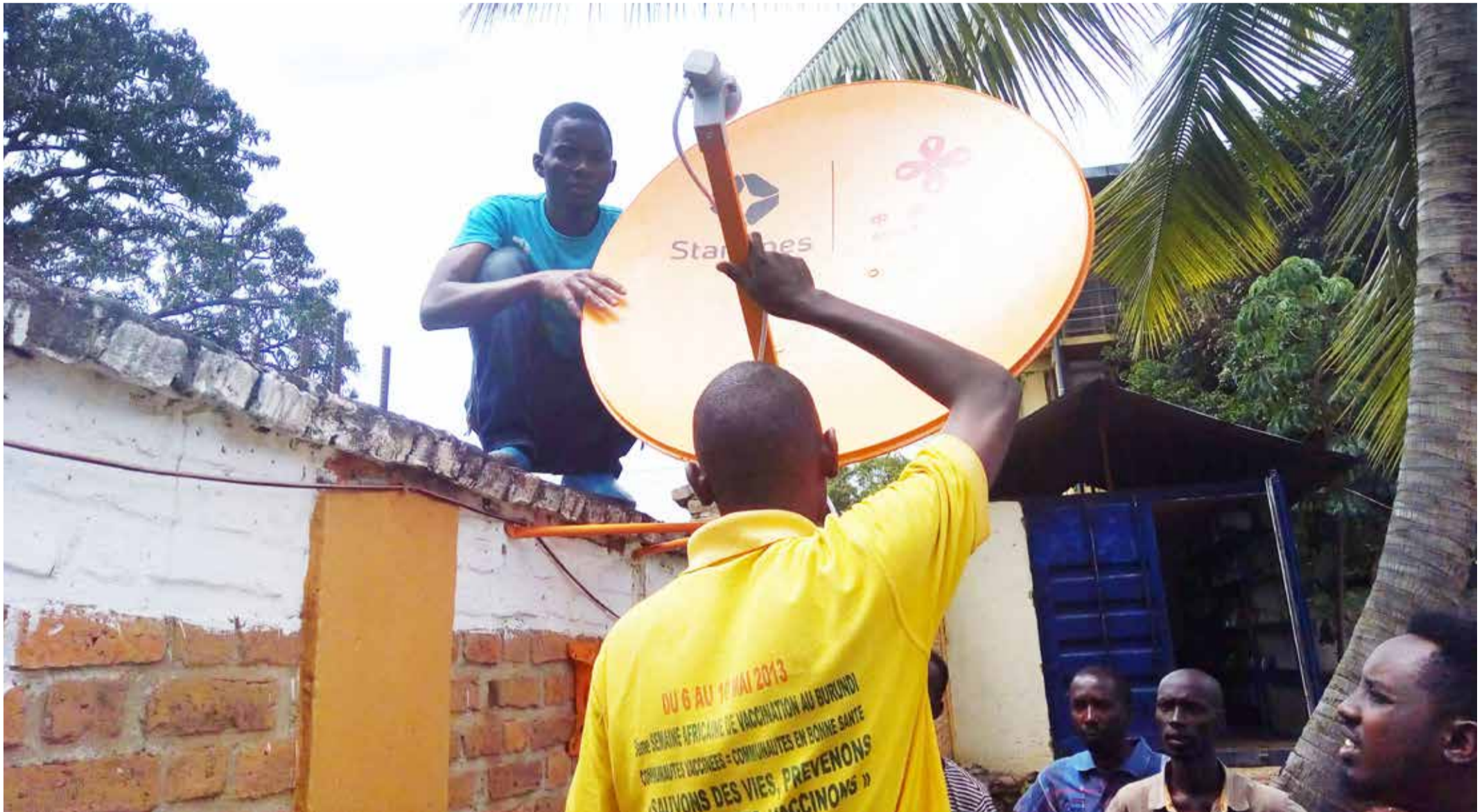
Le projet d'accès à la télévision satellitaire pour 10 000 villages africains a permis l'installation des équipements facilitant la réception du signal numérique dans 300 villages burundais
