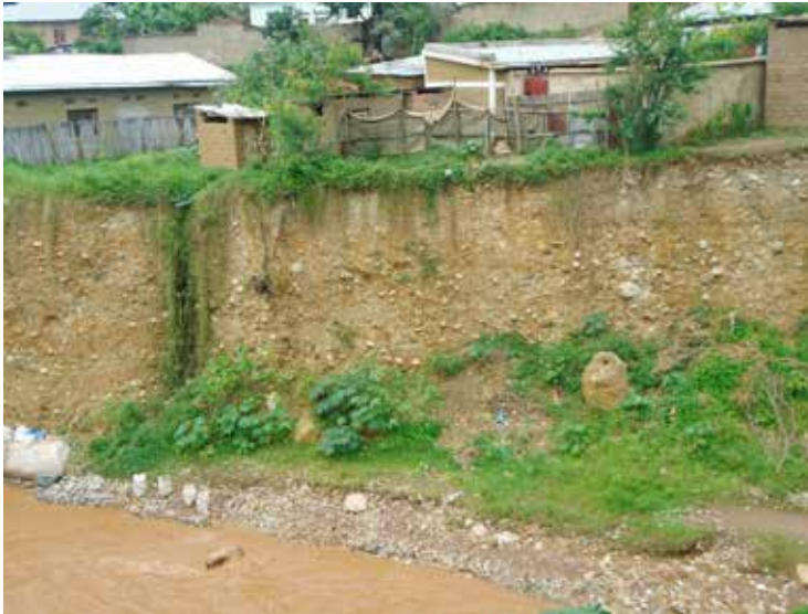
Les infrastructures riveraines de la rivière Kanyosha menacées.
