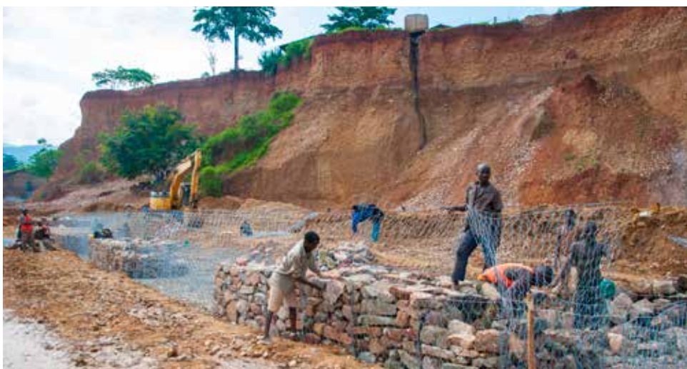
Travaux de réhabilitation des berges de la rivière Ntakangwa / ©Fleury Kid Ineza, PNUD Burundi
