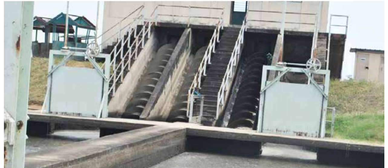
La gestion des eaux usées présente des lacunes dans la municipalité de Bujumbura. Très peu de quartiers sont raccordés à la station d'épuration de Buterere.
