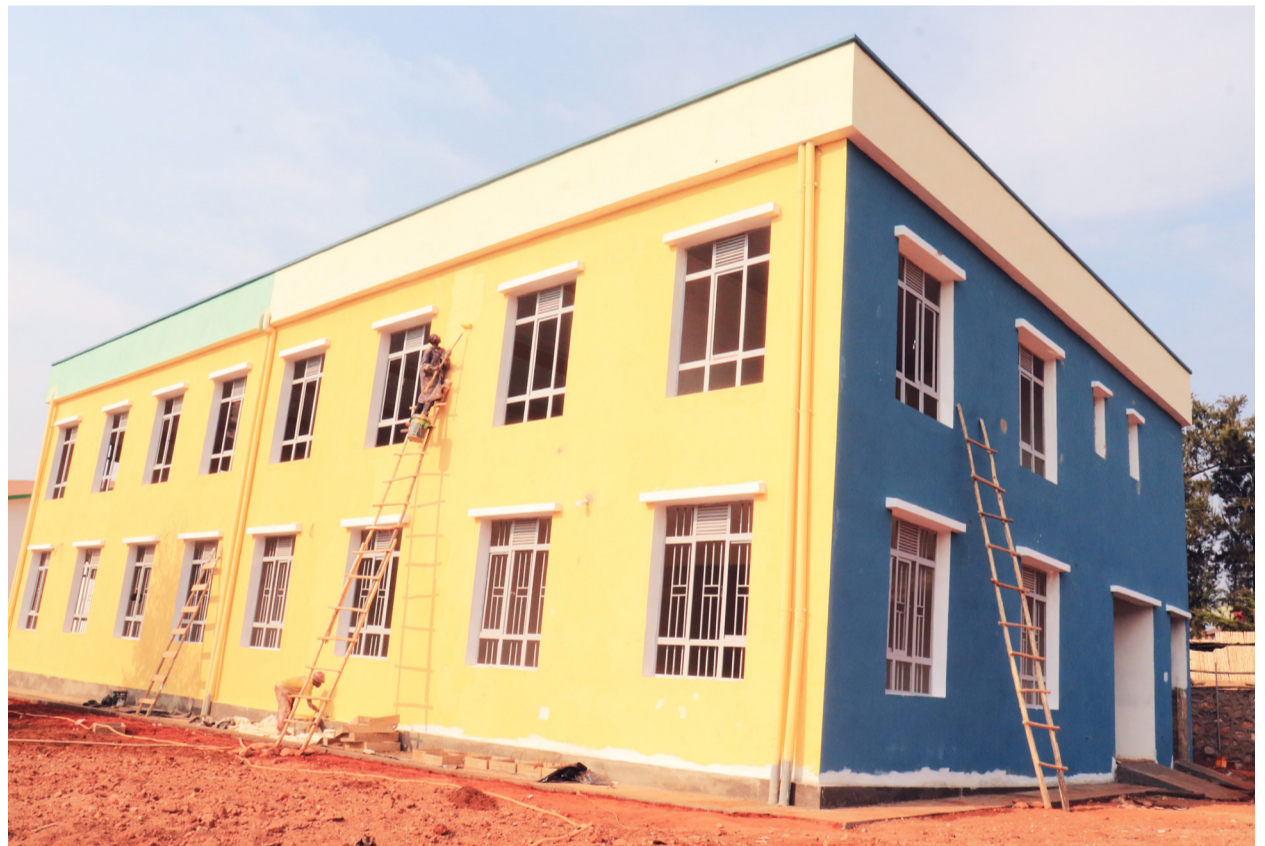
Les travaux de finissage du centre de développement intégré pour les femmes de la commune de Gitega sont en cours. Le projet est financé à hauteur de plus de 300 000 euros.
