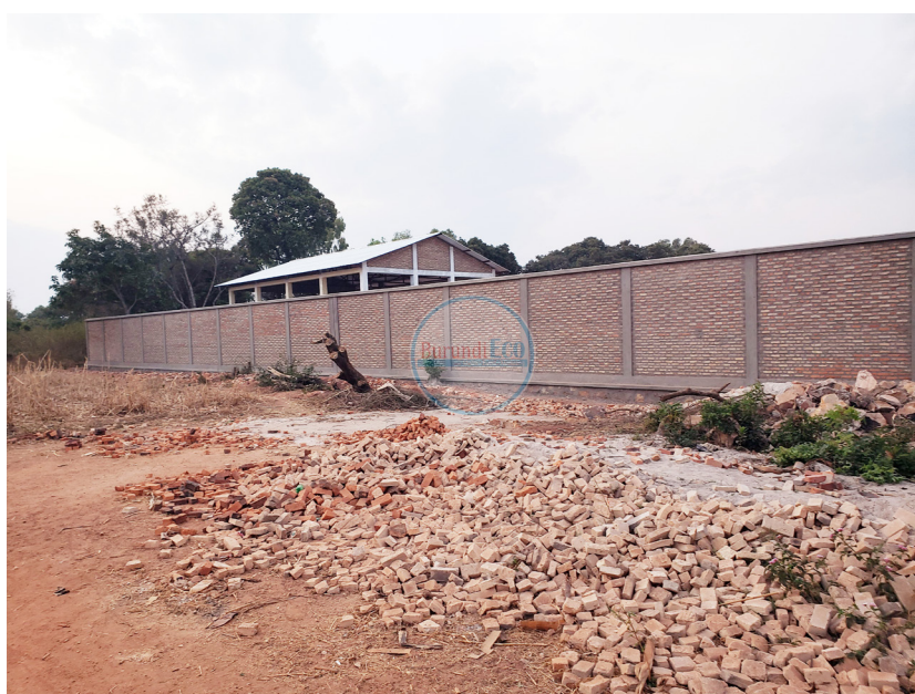
Le centre accueillant les anciens enfants de la rue à Mishiha est en cours de construction.
