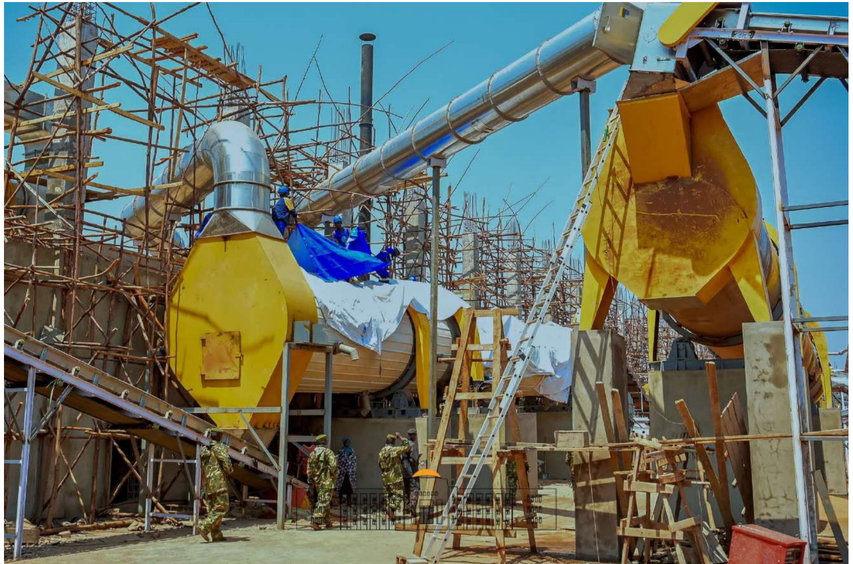
Chantier de construction d'une cimenterie à Bukemba au Sud du pays (Photo : Ntare house).
