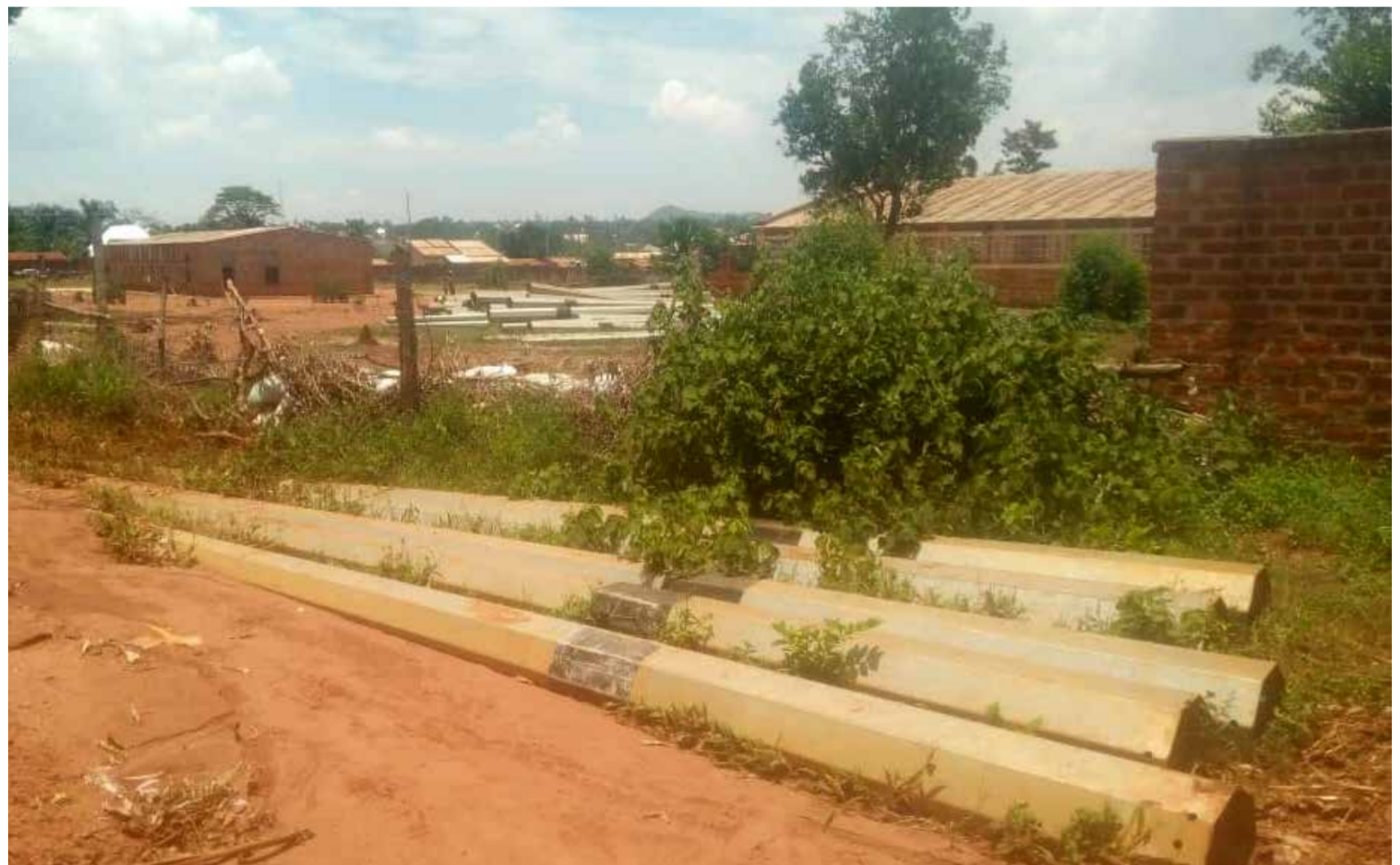
Des poteaux métalliques sont en cours d'installation dans la région de Kumoso afin d'approvisionner cette zone en électricité.
