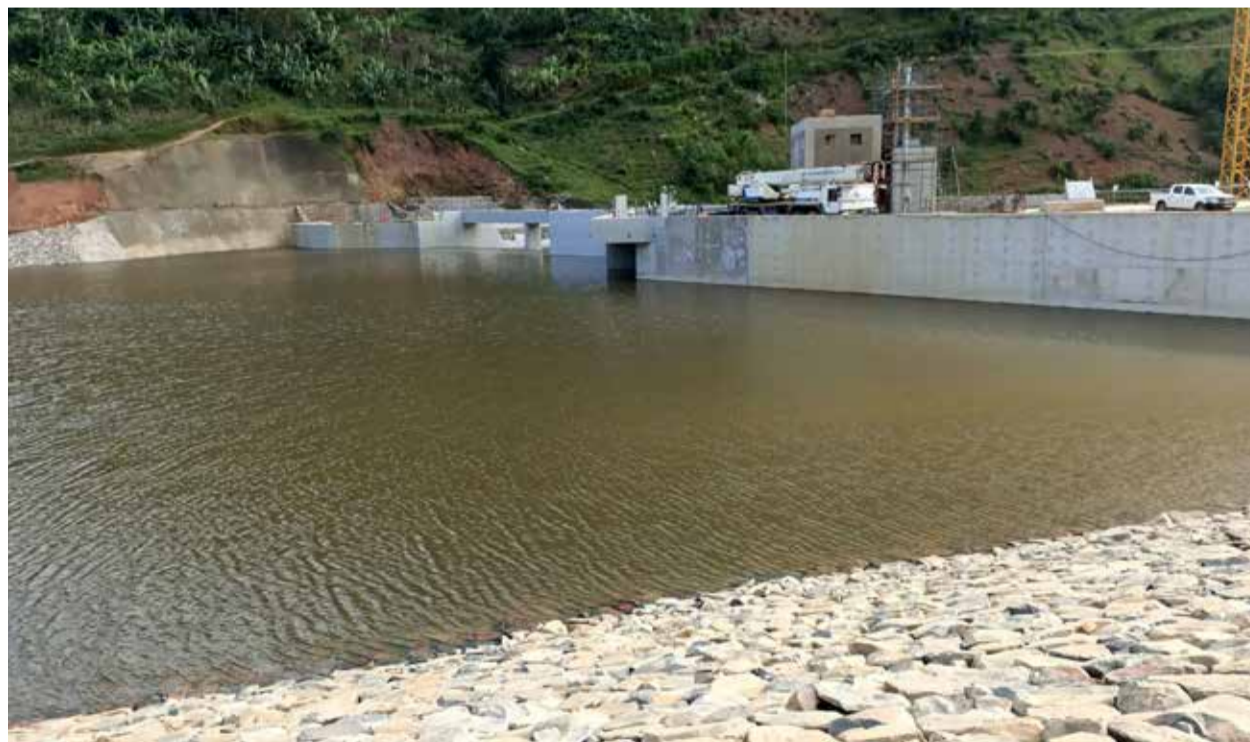
Les centrales hydroélectriques de Jiji et Murembwe représentent un tournant majeur dans le secteur énergétique burundais.
