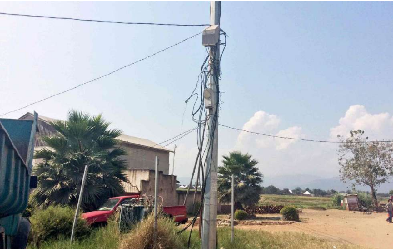
Tant qu'on ne parvient pas à réhabiliter le réseau de transport d'électricité, il y aura toujours des coupures intempestives d'électricité dues à la vétusté des équipements
